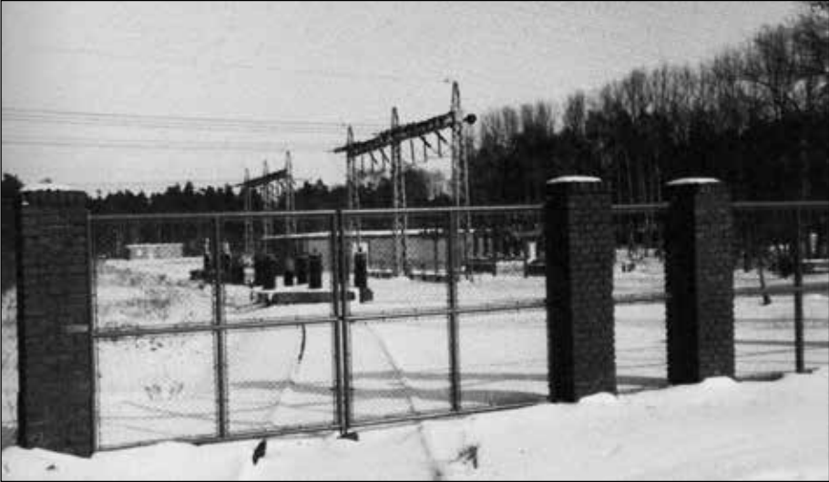
Umspannstation der HEW in Alt Garge (Foto: Hopp)
